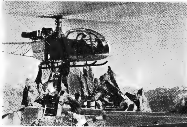
Lastentransport im Hochgebirge. Hier bringt ein Hubschrauber der Süd-Aviation „Alouette“ Material für den Bau einer Schutzhütte auf ein 3100 m hohes Plateau des Mont Blanc. Es wurden 60 t auf diese Weise befördert.
