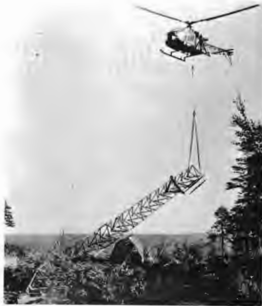
Hubschrauber beim Bau von Hochspannungsleitungen. Hubschrauber Alouette bringt einen Hochspannungsgittermast an seinen vorbereiteten Platz und richtet ihn auf.
